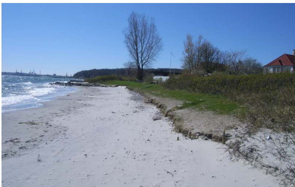
Figur 3-10 Stenhøjde og udløbsledning samt erosion af digefod ved Platanvej.
