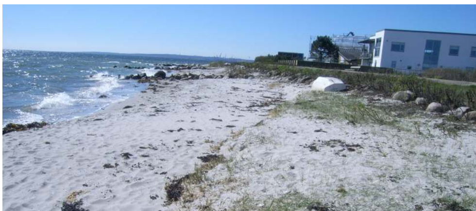
Figur 3-29 Smal strand med stenhøfder nord for Vejlbj Hage. Diget er beskyttet af en usammenhængende stenkastning langs digefoden. Digefoden kan blive udsat for erosion
