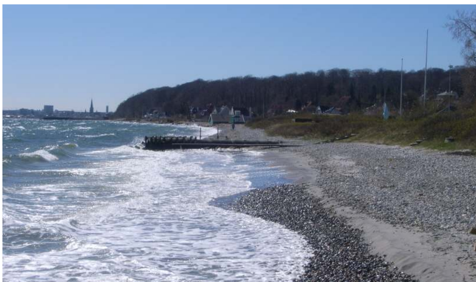
Figur 3-8 Ralstrand og hofde med udløbsrør syd for Platanvej. Fiberdugen er blotlagt langs digets fod
