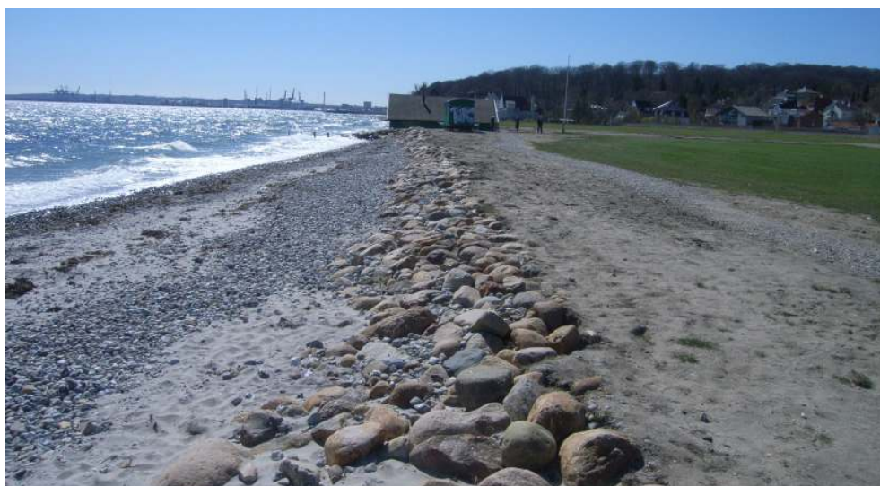
Figur 3-7 Unødvendig og uhensigtsmæssig ny skråningsbeskyttelse ved Hospitalsgrunden
