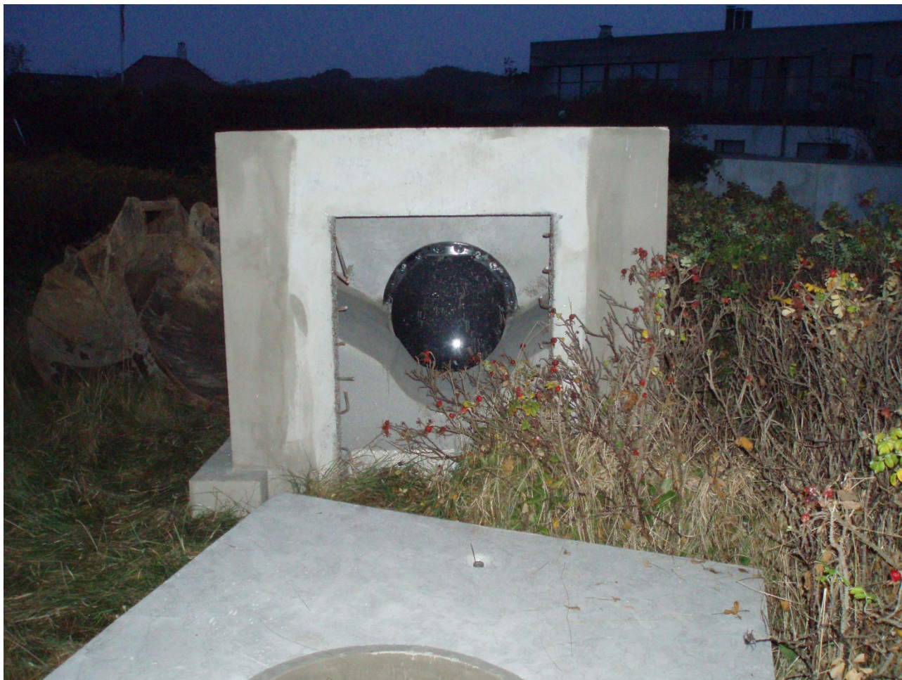
Brønd med klappen til Rønnevej og låget til at lægge over brønden før montage.
