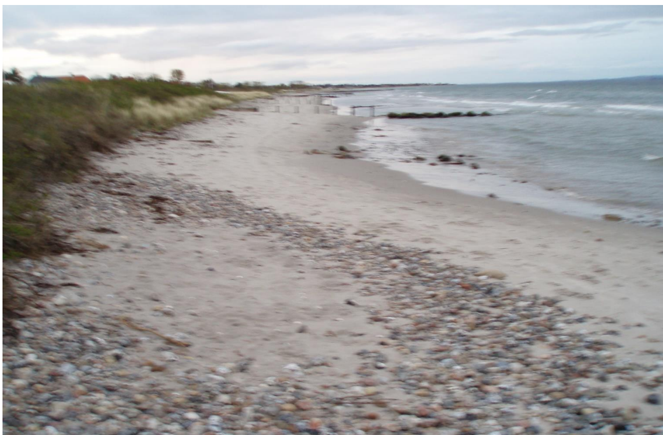
Området lige nordøst for udløbet/stenkastningen ved Rønnevej. Let erosion ved digefoden.
