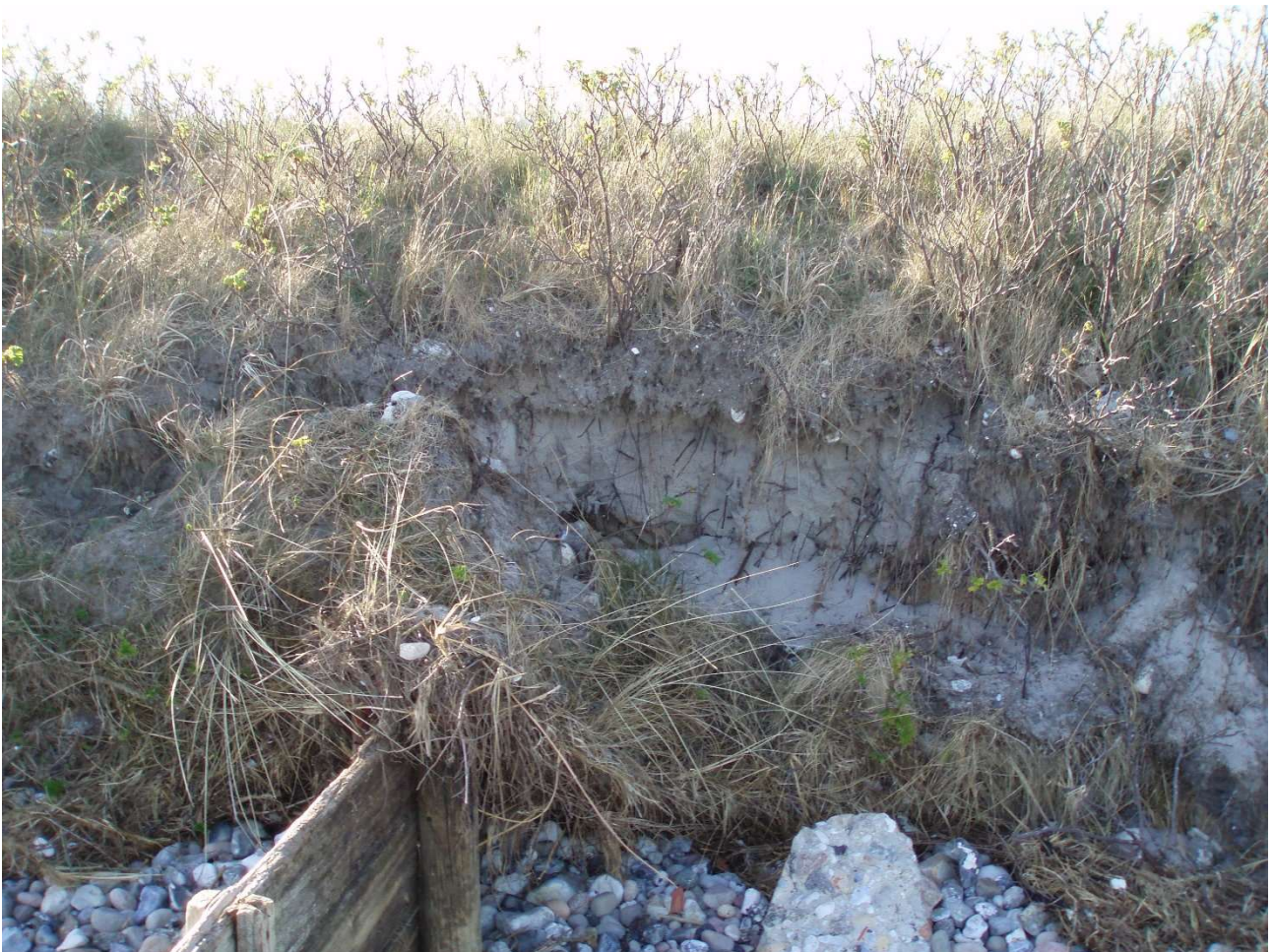
(4) Rønnevej. Erosion i digefoden p.g.a. den store stenhøjde accentueret 80 cm ind af træhøjderest.
