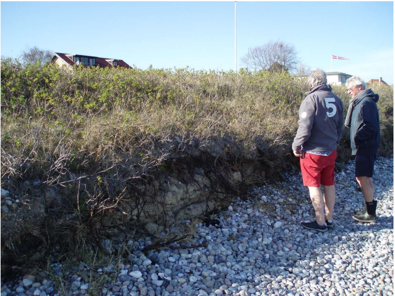
(5) Rønnevej: Erosion i digefoden pga. den store stenhøjde, strækker sig hen til Lindevangsvej.
