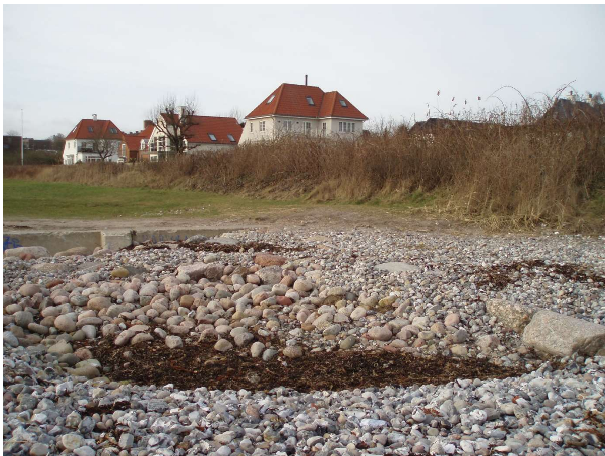
(1) Strandparken: Eroderet i stenbedet ved overløbet ned over stranden, men til siden solid kampestenssikring.
