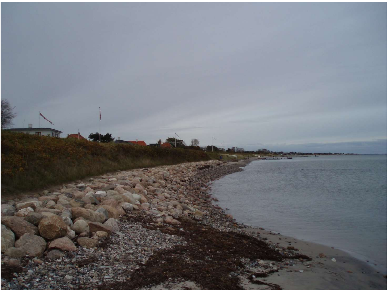
(3) Den anlagte digefodsbeskyttelse ved Rønnevej/Lindevangsvej –læsideerosion!
