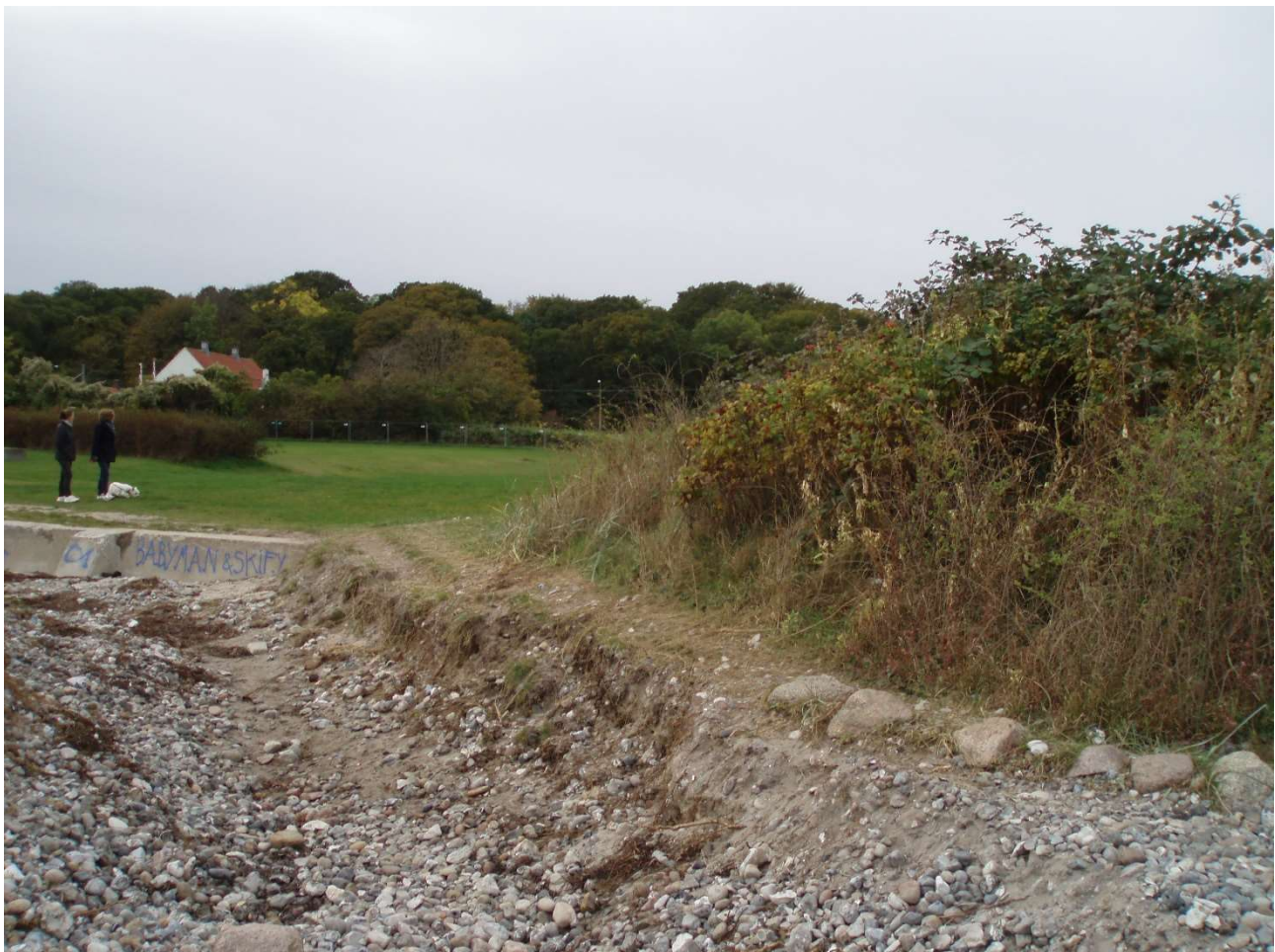
(1)Erosion digenært, med dybe render efter regnskyl via overløbet til LU23g over Hospitalsgrunden
