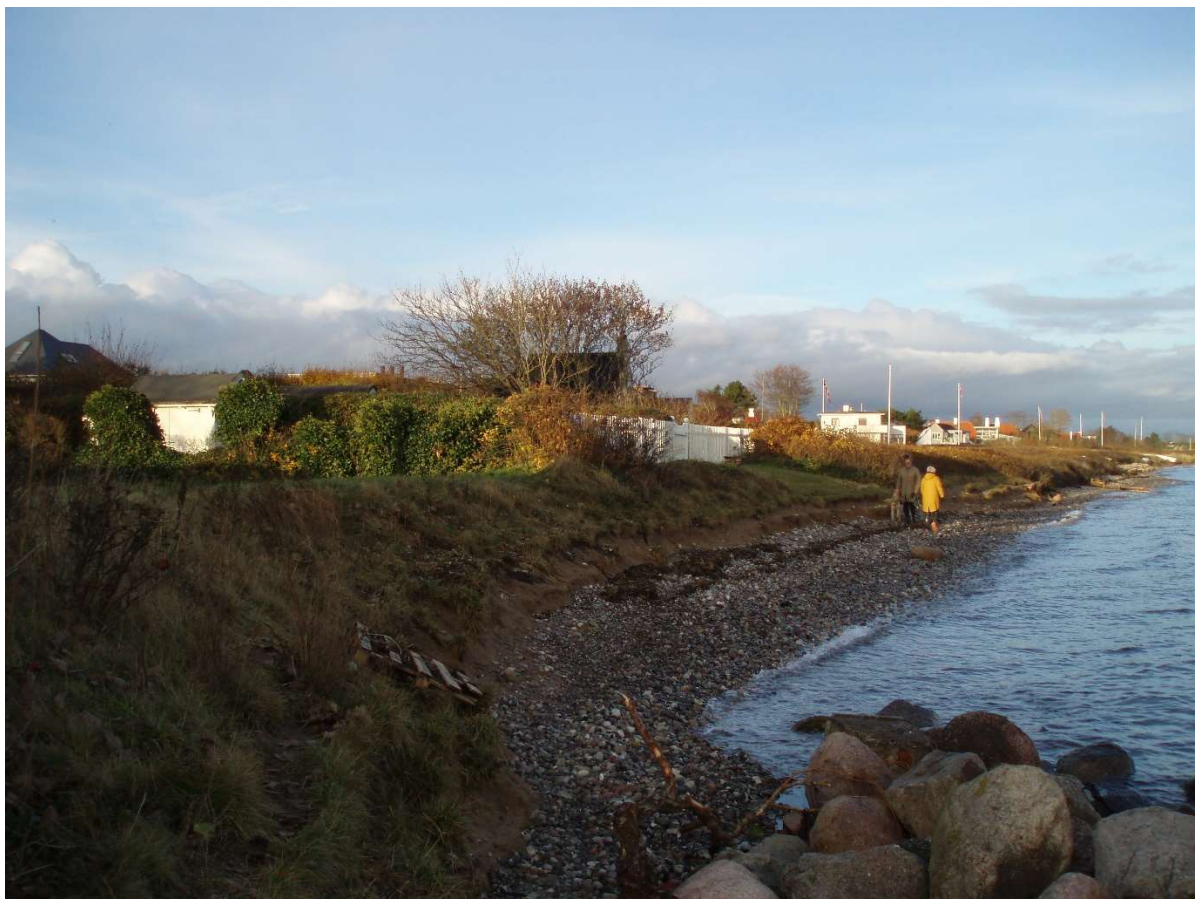
(4) Ved Platanvej. Smal og lav og stenet strand, digefoden påvirket.
