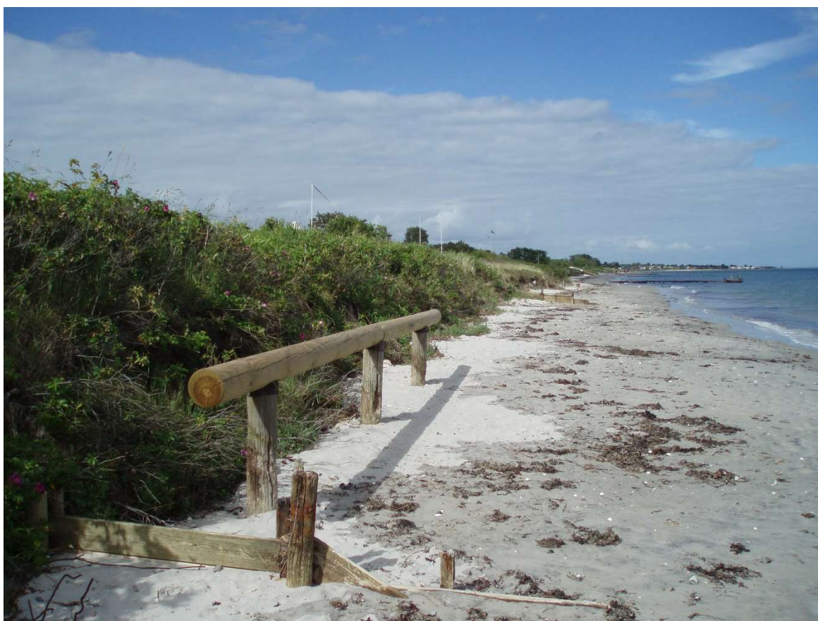
6) Lindevangsvej med let erosion af digefoden. Der er taget knapt \frac{1}{2} meter af højden på stranden, se på pælene! Installationen med pælene er ikke god i vinterhalvåret, de kan fremme erosion.
